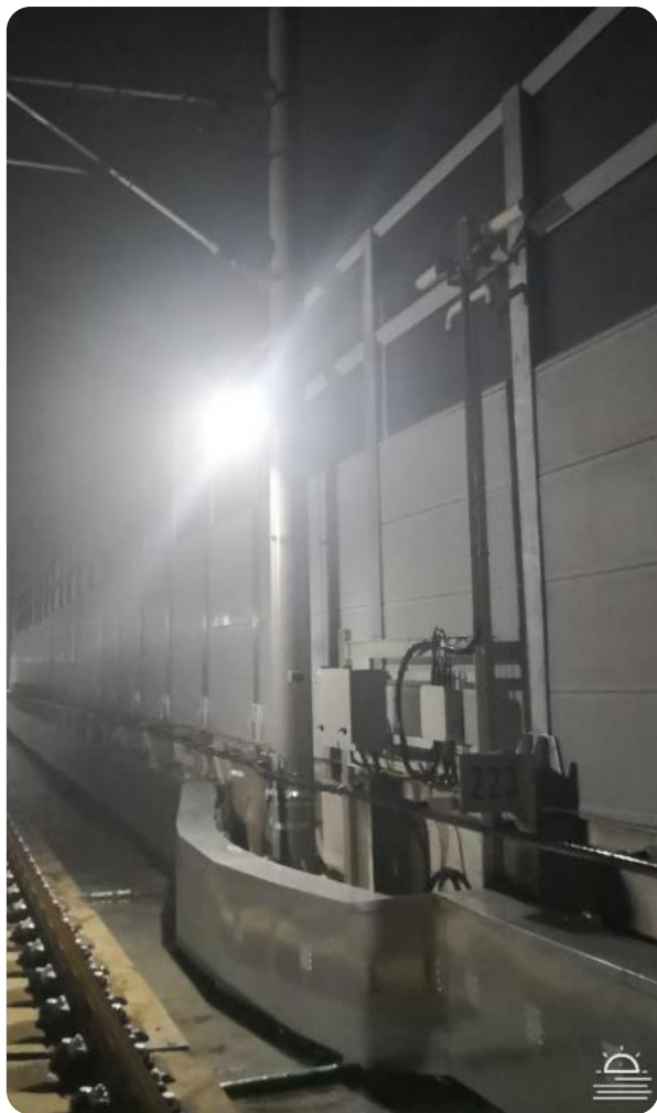
接触网支柱遮挡
