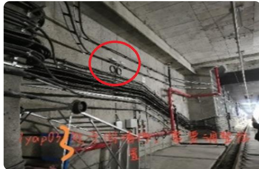
轨旁设备位于凹坑内
